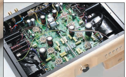
Die Netz- und Ausgangsübertrager befinden sich rechts und links. Vorsicht: An den Stromglättungs-Elkos stehen 400 Volt an.
